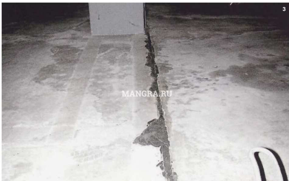
Рис. 3. Изначальное состояние рабочего шва «пол - вертикальная опора» с видимыми сколами до санации
