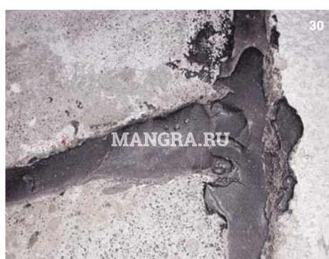
Рис. 31. Состояние узла соединения «деформационный шов - рабочий шов» после санации
