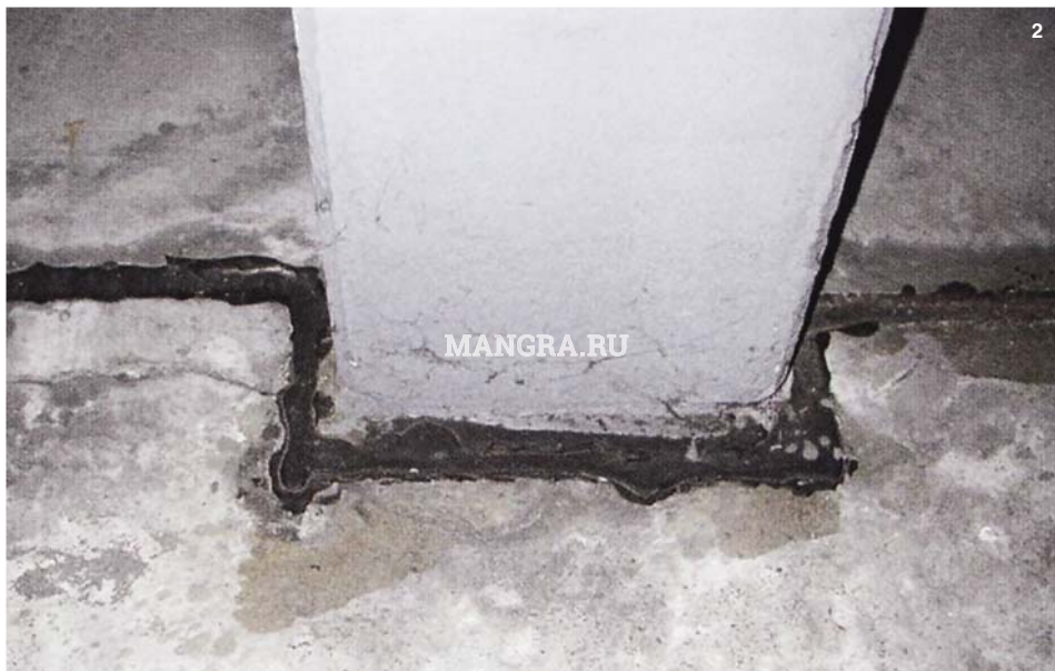
Рис. 2. Изначальное состояние рабочего шва «пол - вертикальная опора» с видимыми сколами до санации
