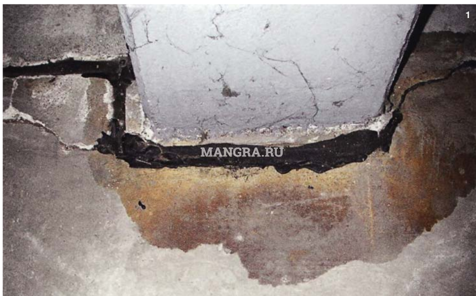
Рис. 1. Изначальное состояние рабочего шва «пол - вертикальная опора» с большими сколами до санации
