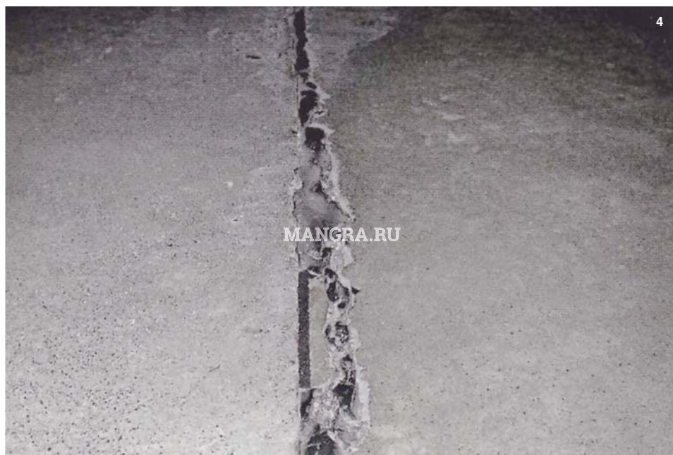
Рис. 4. Нефункционирующий деформационный шов со сколами на проезжей части подземного паркинга
