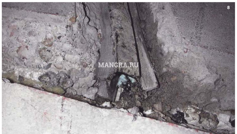
Рис. 8. Обнаженная гидрошпонка после удаления герметика и выпилки бетона
