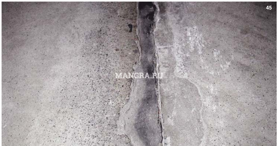
Рис. 45. Состояние шва на полу подземного паркинга до санации
