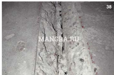
Рис. 38. Состояние шва после вырубки бетона и демонтажа старого герметика
