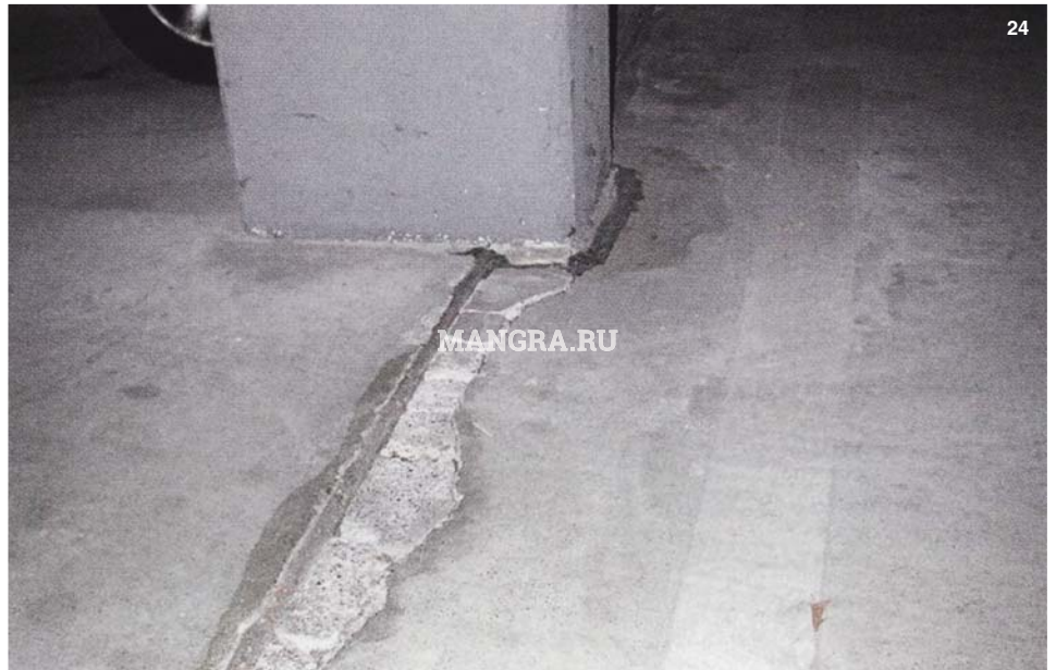
Рис. 24. Состояние деформационного шва при въезде на паркинг до санации
