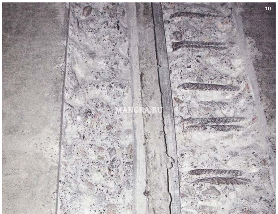
Рис. 10. Хорошо заметные различия бетонного покрытия на кромках деформационного шва
